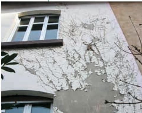
Efeuschaden aufgrund eines falschen Untergrundes und falscher Materialien (Putzuntergrund, Wandfarbe ...)
