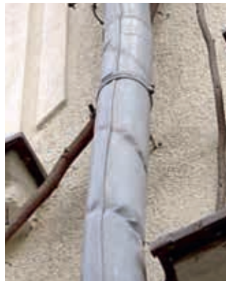
Abb. links: Die Triebe der Glyzinie wachsen durch ein Lochblech und werden dadurch abgeklemt.
