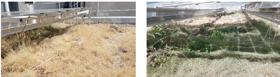
Abb. 58: Vegetation auf der freien Dachfläche (links) und unter den PV-Modulen (rechts) während einer Hitzeperiode.
