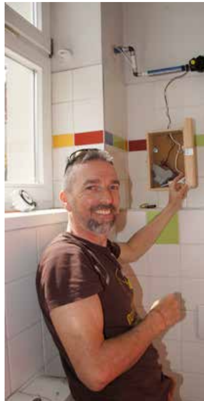
Abb. 30: Im GRG 7 hat der Turnlehrer das Umstellen der Zeitschaltuhren übernommen.
