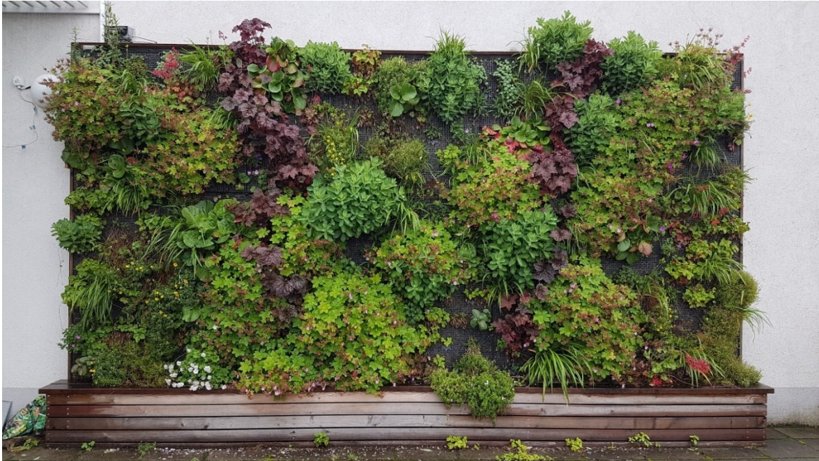
Abbildung 7: Kassettensystem auf der Dachterrasse BGR15
